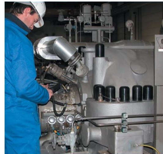
Service manutenzione predittiva con strumenti fissi e portatili
