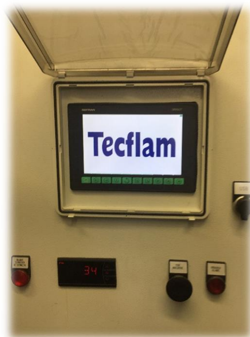
2. Foto dell'interfaccia del quadro elettrico di gestione.
