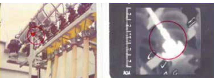
Sistema THERMOVISION applicato agli impianti elettrici e in fase di collaudo motori FOTO NORMALE / FOTO IR
