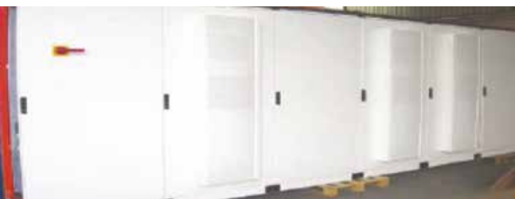
Quadro comando linea taglio lamiera Fiat Cas- sino – Centro Presse (29 mt di carpenterie – tre PLC S7-300 319F in rete – otto pannelli operato- ri – 32 azio-namenti in rete – cinquantacinque en-coder per posizionamento - circa 2200 I/O)
