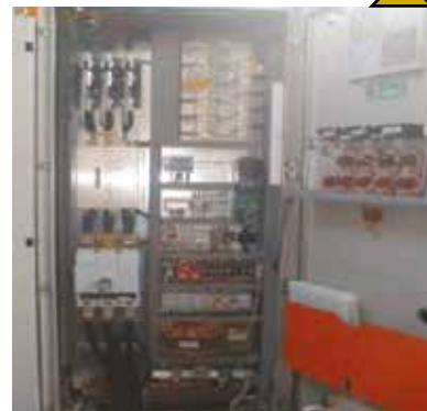
Quadro gestione motore AC in anello chiuso da 264Kw
