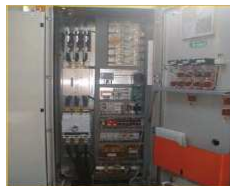
Quadro gestione motore AC in anello chiuso da 264Kw
