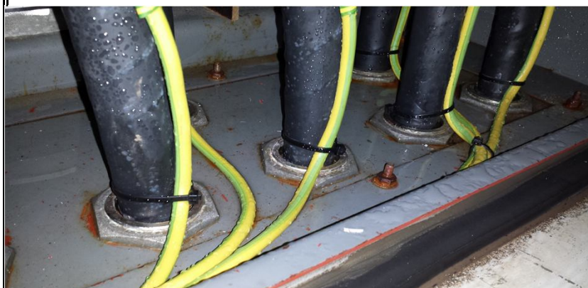
DEPOSITO DI ACQUA SUL FONDO BASETTA USCITA CAVI GENERATORE
