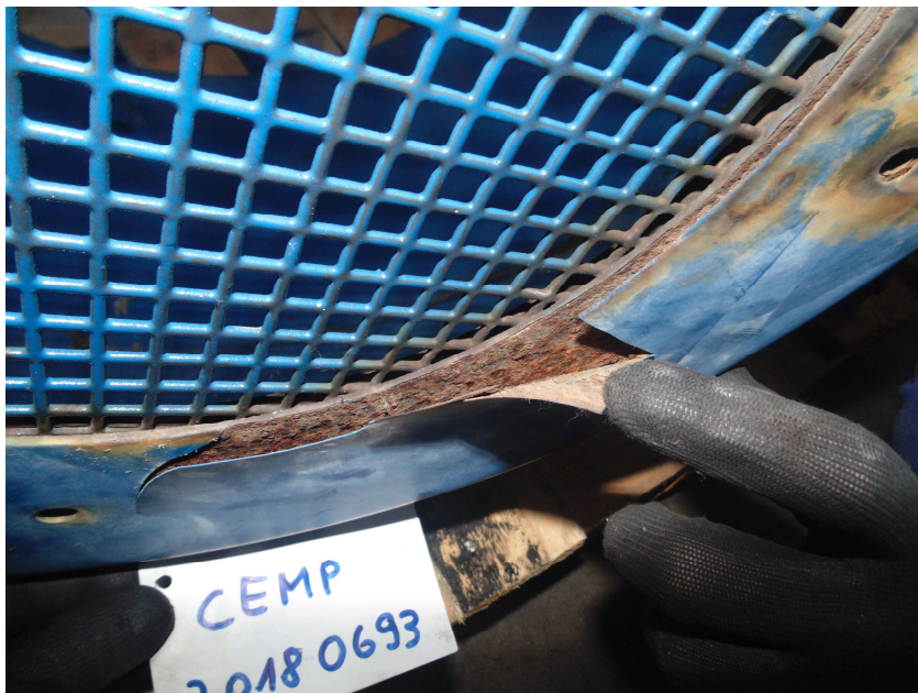
Foto dello stato del cuffia copriventola
