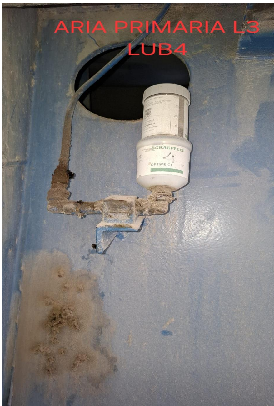
VENTILATORE ARIA PRIMARIA LINEA 3 LUBRIFICAZIONE SUPPORTO VENTILATORE LATO OPPOSTO GIUNTO
